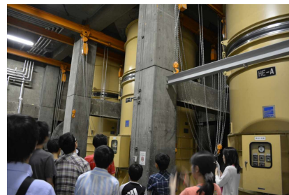
トンネル内の空気を浄化する機械
