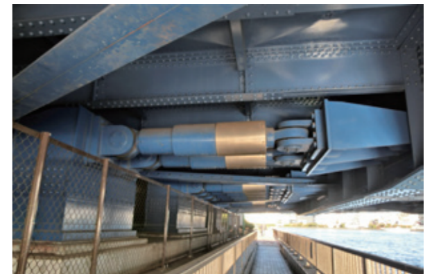
清洲橋に設置された制震ダンパー
