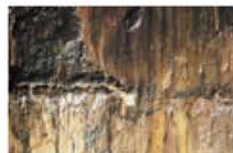
樹液採取の傷(上) 樹液採取の傷を持つ杭(右)
