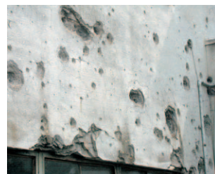
外壁に残る生々しい弾痕
