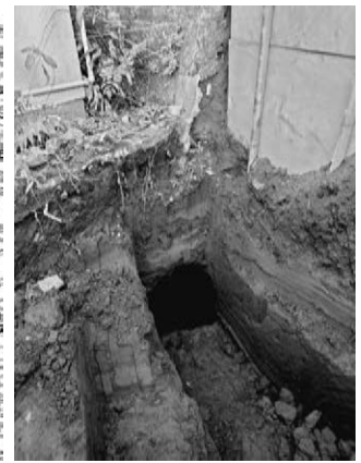
第3図 側壁開孔状況
